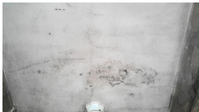
INS003 Maison - Entrée PH:20260223-021107 plafond - plâtre (peinture) Moisissure (présence d'indice)
