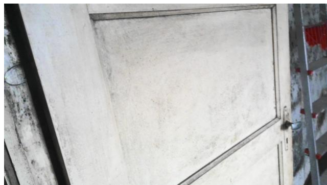
INS066 Maison - Dégagement 2 PH:20260223-021852 porte - bois (peinture) Moissure (présence d'indice)
