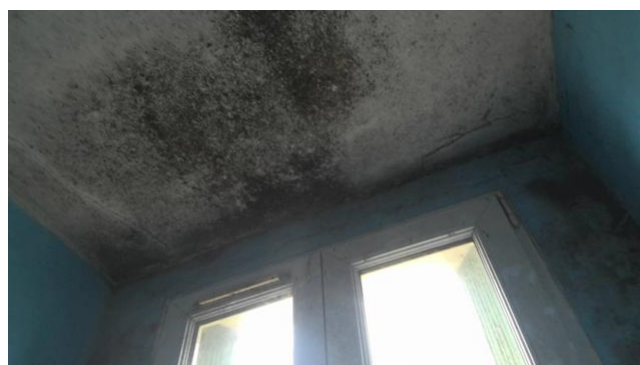
INS089 Maison - Salle de bain PH:20260223-022542 plafond - plâtre (peinture) Moisissure (présence d'indice)
