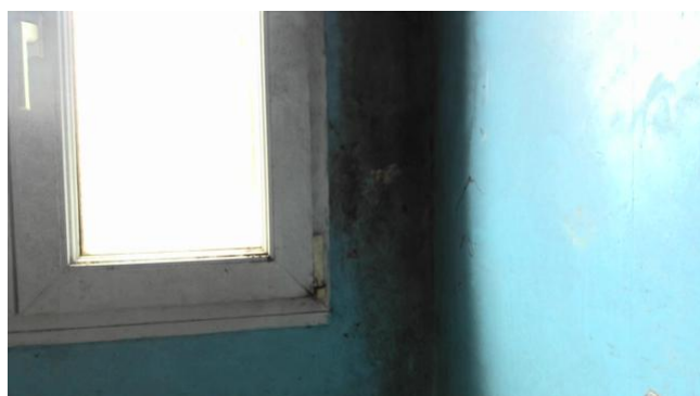
INS088 Maison - Salle de bain PH:20260223-022529 mur - plâtre (peinture) Moisissure (présence d'indice)
