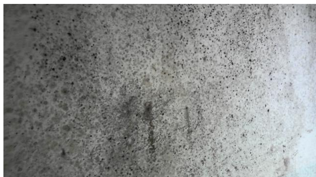
INS002 Maison - Entrée PH:20260223-020110 mur - plâtre (peinture) Moisissure (présence d'indice)
