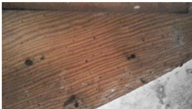
INS036 Maison - Toilette PH:20260223-024809 plafond - bois (brut) Petite vrillette, Grosse vrillette (présence d'indice)
