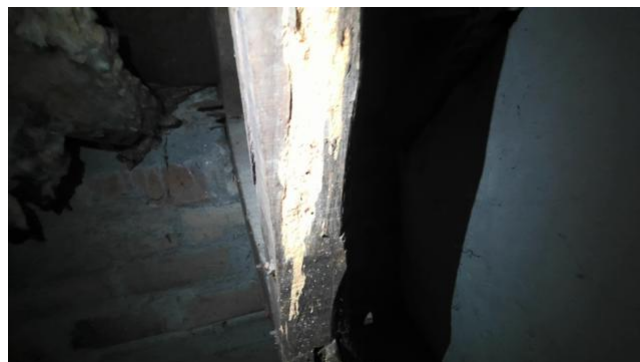
INS109 Maison - Grenier 2 PH:20260223-023250 plafond - charpente bois (ardoises naturelles) insectes à larves xylophages (ILX) (présence d'indice)
