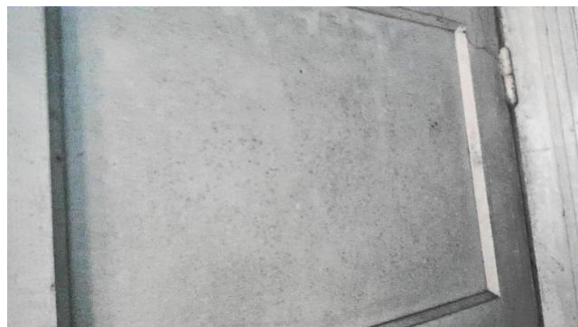
INS091 Maison - Salle de bain PH:20260223-022914 porte - bois (peinture) Moisissure (présence d'indice)
