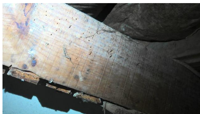
INS072 Maison - Grenier PH:20260223-021718 plafond - charpente bois (ardoises naturelles) insectes à larves xylophages (ILX) (présence d'indice)
