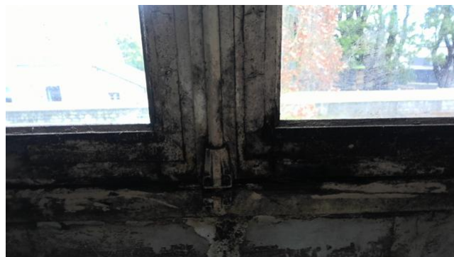
INS084 Maison - Chambre + placard 3 PH:20260223-022209 huisserie fenêtre - bois (peinture) Moisissure (présence d'indice)
