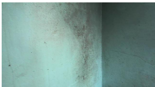
INS043 Maison - Cuisine PH:20260223-031207 mur - plâtre (peinture et faïence) Moisissure (présence d'indice)
