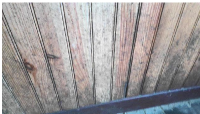
INS054 Maison - Séjour PH:20260223-031544 mur - non vérifiable (lambris) Moissure (présence d'indice)
