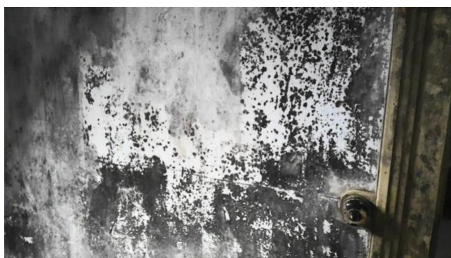
INS063 Maison - Dégagement 2 PH:20260223-021552 mur - plâtre (peinture) Moissure (présence d'indice)
