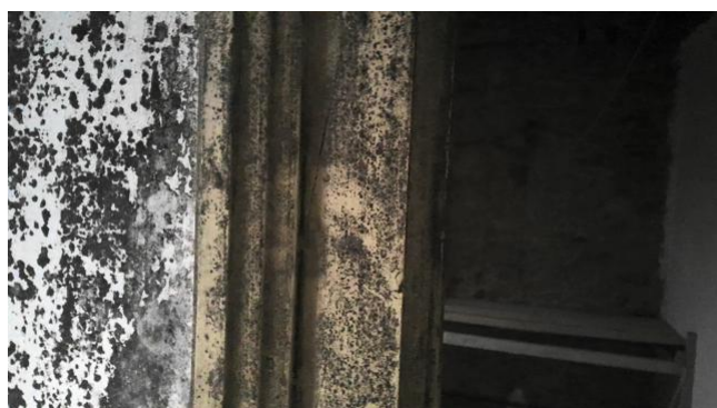
INS067 Maison - Dégagement 2 PH:20260223-021925 huissierie porte - bois (peinture) Moissure (présence d'indice)
