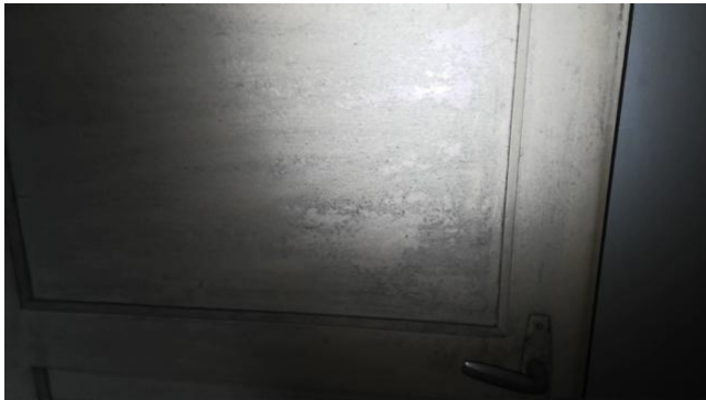
INS111 Maison - Grenier 2 PH:20260223-023346 porte - bois (peinture) Moisissure (présence d'indice)
