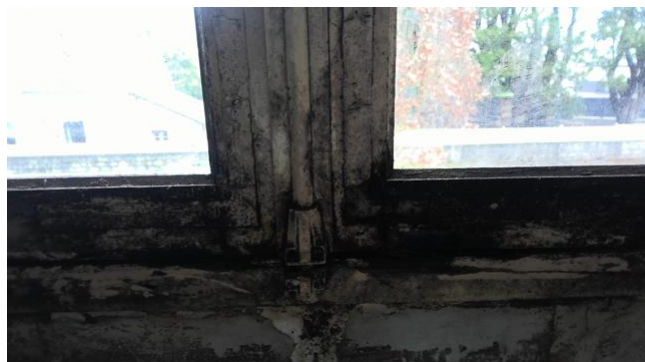
INS083 Maison - Chambre + placard 3 PH:20260223-022209 fenêtre - bois (peinture) Moisissure (présence d'indice)
