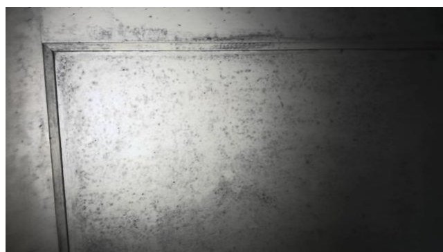
INS074 Maison - Grenier PH:20260223-021752 porte - bois (peinture) Moissure (présence d'indice)
