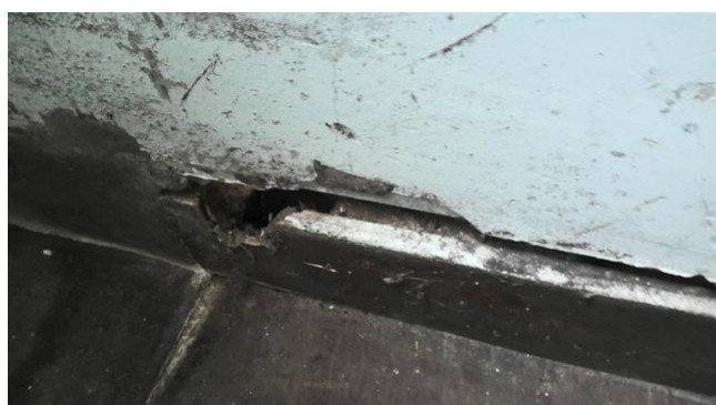
INS004 Maison - Entrée PH:20260223-020324 plinthe - bois (brut) Pourriture cubique (présence d'indice)
