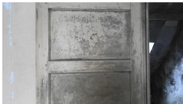
INS100 Maison - Chambre + placard 4 PH:20260223-023100 porte - bois (peinture) Moisissure (présence d'indice)
