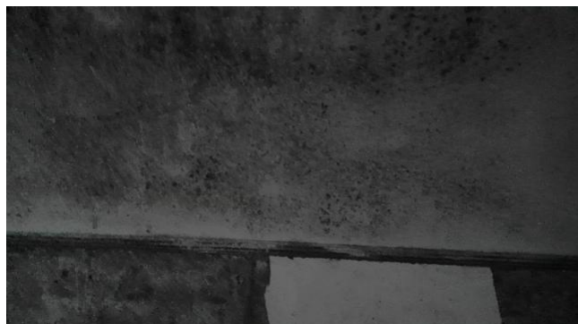
INS064 Maison - Dégagement 2 PH:20260223-021528 plafond - plâtre (peinture/papier peint) Moissure (présence d'indice)
