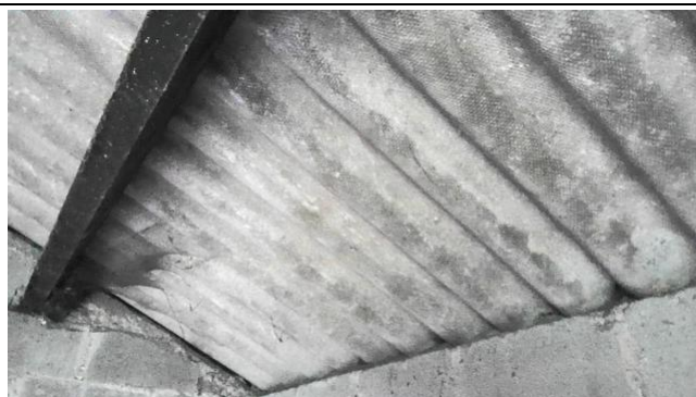
002 : plaques ondulées en amiante-ciment Garage (niv:0)
