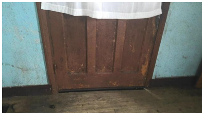
INS046 Maison - Cuisine PH:20260223-031723 porte - bois (peinture) Moissure (présence d'indice)
