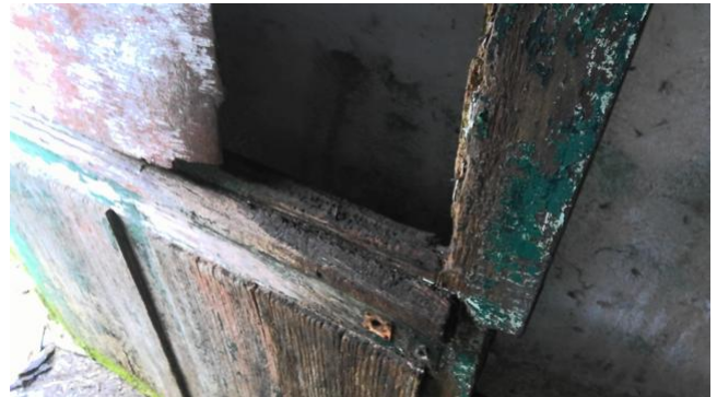
INS130 Maison - Garage PH:20260223-025132 porte - bois (peinture) Pourriture cubique (présence d'indice)
