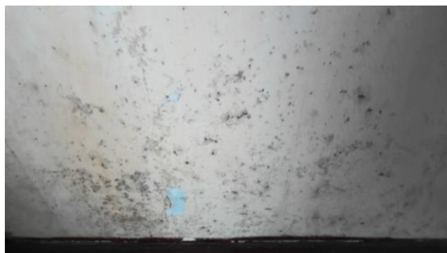
INS053 Maison - Séjour PH:20260223-021338 mur - plâtre (peinture/papier peint) Moissure (présence d'indice)
