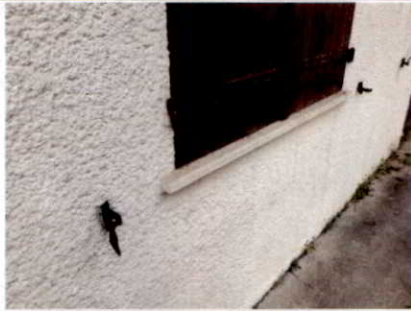
Photo n° PhA001 Localisation : Maison - Façades Ouvrage : Appuis de fenêtres Partie d'ouvrage : Eléments fibres-ciment Description : Eléments fibres-ciment
