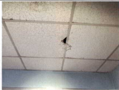
Photo n° PhA003 Localisation : Maison - Entrée/Séjour; Maison - Pièce 1; Maison - Pièce 2; Maison - Pièce 3; Maison - Cuisine; Maison - Point d'eau; Maison - Wc 1; Maison - Wc 2 Ouvrage : Flocages, Calorifugeages, Faux plafonds Partie d'ouvrage : Faux plafonds Description : Faux plafonds
