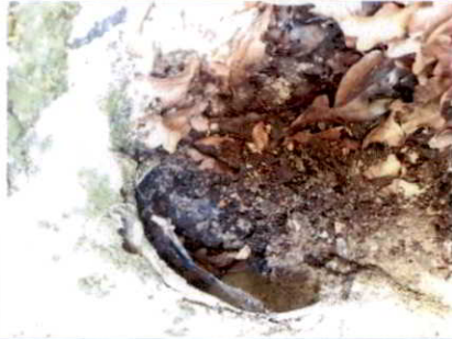
Photo n° PhA002 Localisation : Extérieur - Jardin Ouvrage : Conduits du réseau d'assainissement Partie d'ouvrage : Conduits du réseau d'assainissement Description : Conduits du réseau d'assainissement
