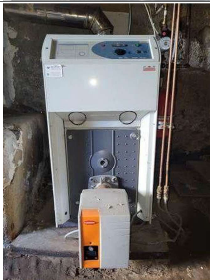
Photo PhDPE002 Ouvrage : Chauffage Description : Cmb_type_installation_nom_donnee
