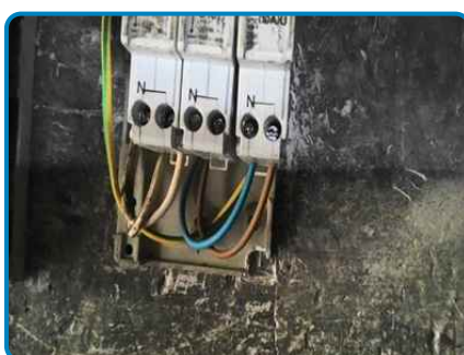
Anomalie B.4.3 f1 sur Install. n°1 App. n°3 (TRP n°3)
