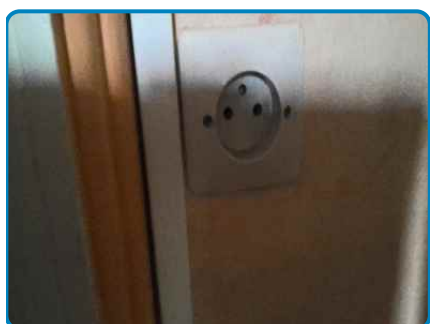
Anomalie B.3.3.6 a1 sur Install. n°1
