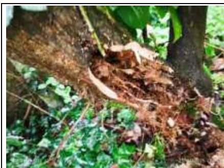
Photo n° PhTer001 Localisation : Parties extérieures Ouvrage : Terrain herbeux et arboré Parasite : Présence d'indices d'infestation d'autres agents de dégradation biologique du bois Indices : altérations dans le bois
