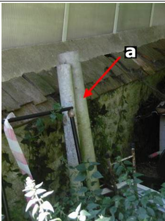
Photo n° PhA002 Localisation : Parties extérieures Ouvrage : Conduits de fluides (air, eau, autres fluides) Partie d'ouvrage : Conduits Description : Dépôt conduits Localisation sur croquis : M002
