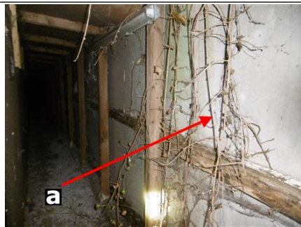
Photo n° PhA001 Localisation : Rez de chaussée - Voilière Ouvrage : Bardages et façades légères Partie d'ouvrage : Plaques (fibres-ciment) Description : Plaques (fibres-ciment) Localisation sur croquis : M001
