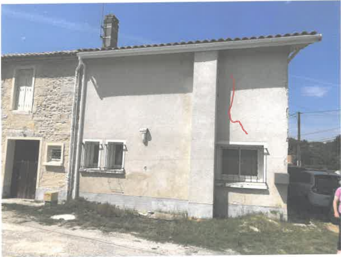
Microfissure verticale à droite du conduit de cheminée avec une amplitude estimée à 1,5 mm.
