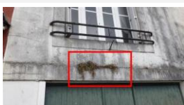
Présence de végétation sur les façades
