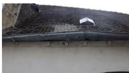
Veillez à l'entretien des descentes d'eaux pluviales, chéneaux et gouttières afin de limiter la stagnation d'eau en pied de murs ou autres infiltrations sur les façades
