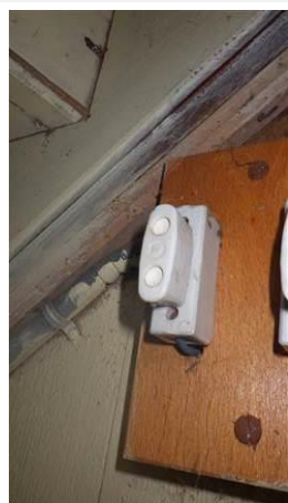
Installation intérieure d'électricité vétuste. Voir diagnostic électricité.
