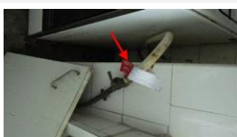
Présence d'anomalie sur l'installation intérieure de gaz. Voir diagnostic gaz.
