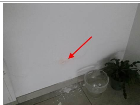
Photo n° PhTer001 Localisation : Rez de chaussée - Pièce de vie Ouvrage : Murs Informations complémentaires : Hygrométrie mesurée très élevée
