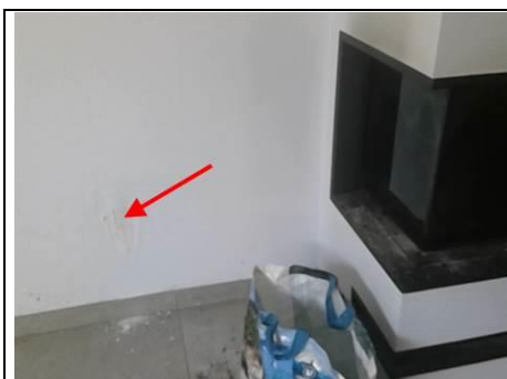
Photo n° PhTer001 Localisation : Rez de chaussée - Pièce de vie Ouvrage : Murs Informations complémentaires : Hygrométrie mesurée très élevée
