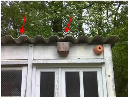
Photo n° PhA004 Localisation : Dépendance - Dépendance Ouvrage : Toitures Partie d'ouvrage : Plaques (fibres-ciment) Description : Plaques (fibres-ciment) Localisation sur croquis : M004
