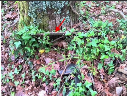
Photo n° PhA003 Localisation : Parties extérieures Ouvrage : Au sol Partie d'ouvrage : Plaques (fibres-ciment) Description : Plaques (fibres-ciment) Localisation sur croquis : M003
