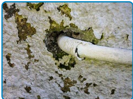
Anomalie 5 (A2) sur Install.n°1 (dans MAISON Rez de chaussée Cellier)
