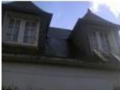
Volet dégradés, cassés
