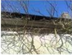
Gouttière dégradée occasionnant fuites et pourrissement .
