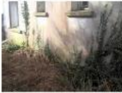
Terrasse, voirie, configuration des lieux et pentes, permettant une stagnation des eaux par fortes pluies, envahissement des pieds de murs par la végétation
