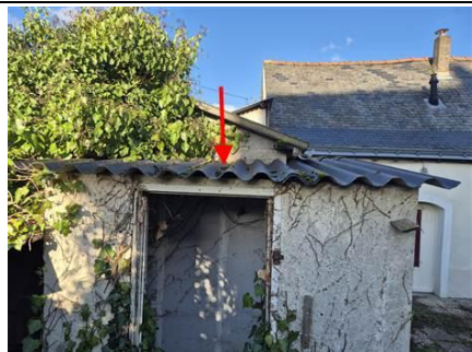
Photo n° PhA003 Localisation : Extérieur - Abris de jardin Ouvrage : Toitures Partie d'ouvrage : Plaques (fibres-ciment) Description : Plaques (fibres-ciment) Localisation sur croquis : C
