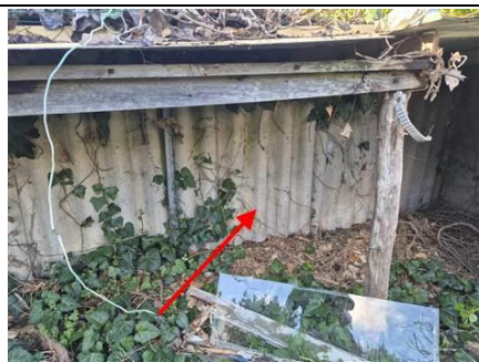
Photo n° PhA002 Localisation : Extérieur - Appentis Ouvrage : Bardages et façades légères Partie d'ouvrage : Plaques (fibres-ciment) Description : Plaques (fibres-ciment) Localisation sur croquis : B
