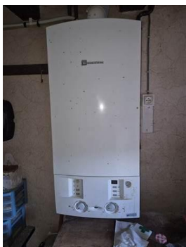
Chauffage central. Photo réalisée le jour de la visite
